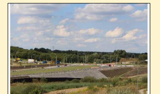
14. Trasa Północna, etap III - Budowa nowej ulicy od ul. Łącznej do ul. Szosa Polska
