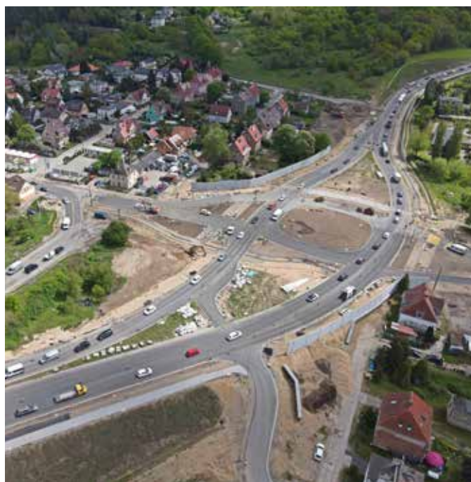
2) Przebudowa ciągów komunikacyjnych DK 31 - rozbudowa skrzyżowania ul. Floriana Krygiera z ul. Granitową z odcinkiem drogi w kierunku autostrady A6. Kwota: 62 010 060 zł.
