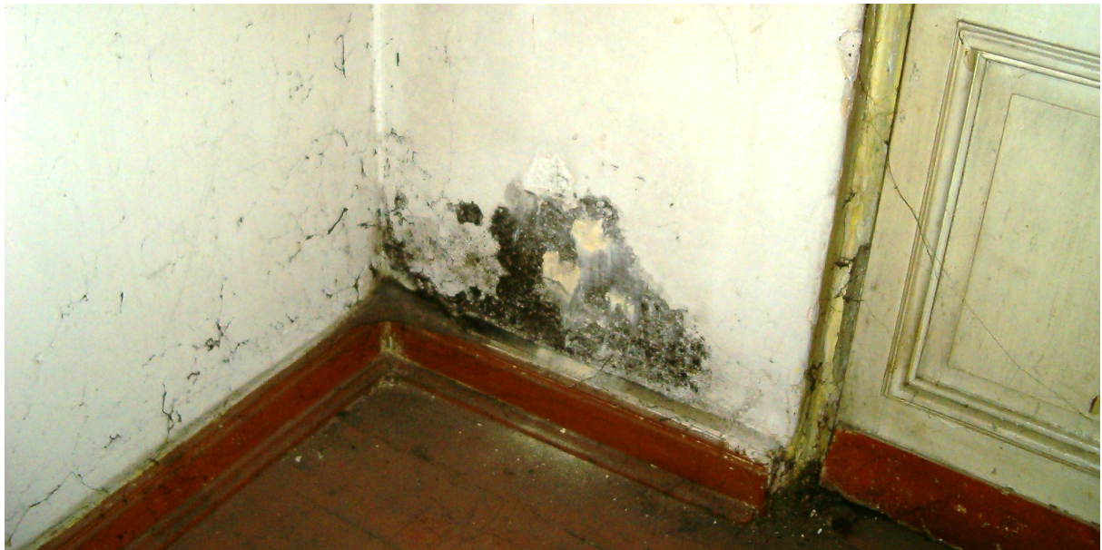
FOT.9. ZAGRZYBIENIE ŚCIAN
