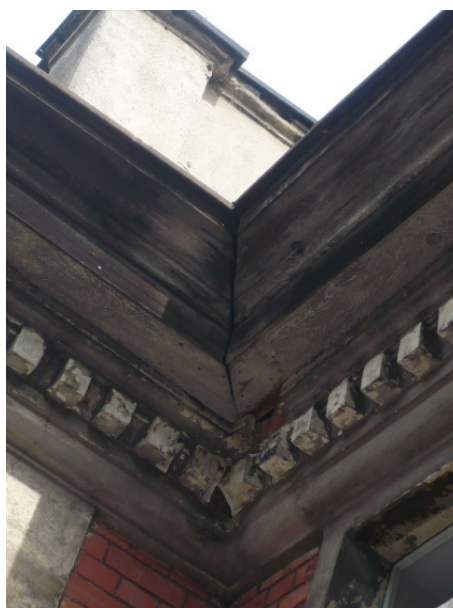
Fot. nr 8. Uszkodzony gzyms wieńczący – widoczna konstrukcja drewniana gzymsu.
