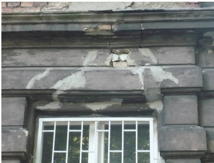
Fot. nr 13. Pęknięcie ściany i nadproża w elewacji frontowej – widoczna szklana plomba.
