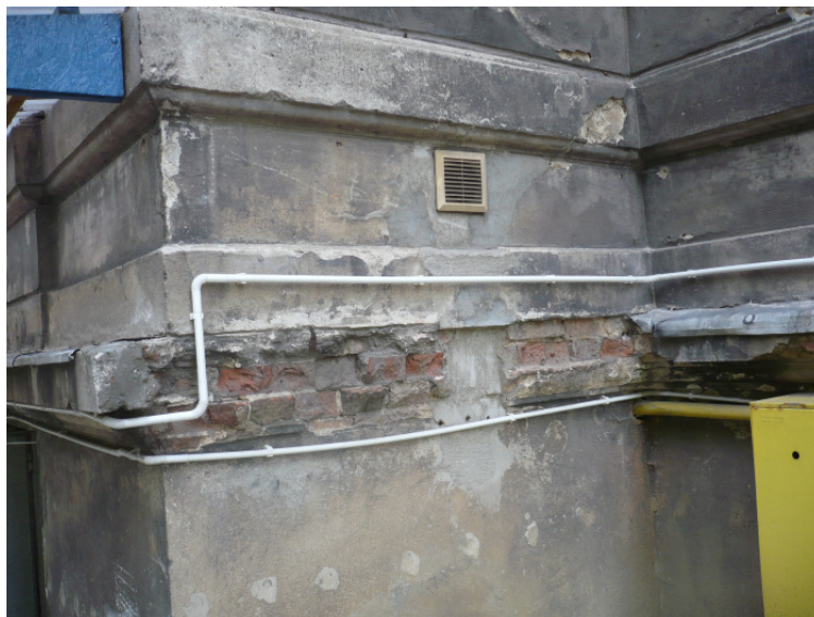
Fot. nr 4. Zniszczony gzyms cokołowy do odtworzenia.
