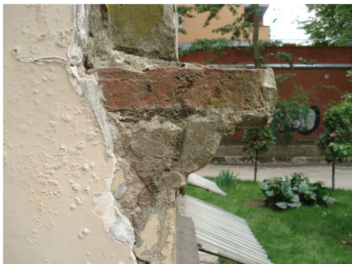
Fot. nr 2. Zawilgocony gzyms cokołowy.
