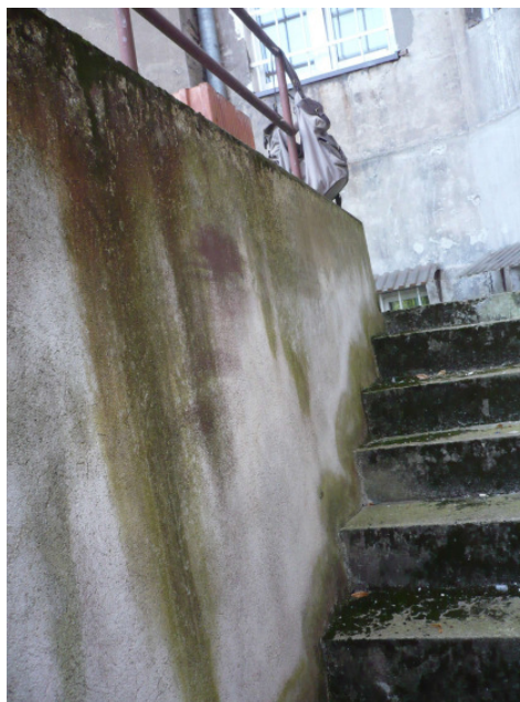
Fot. nr 3. Schody betonowe przy wejściu do piwnicy zawilgocone, pokryte porostami.
