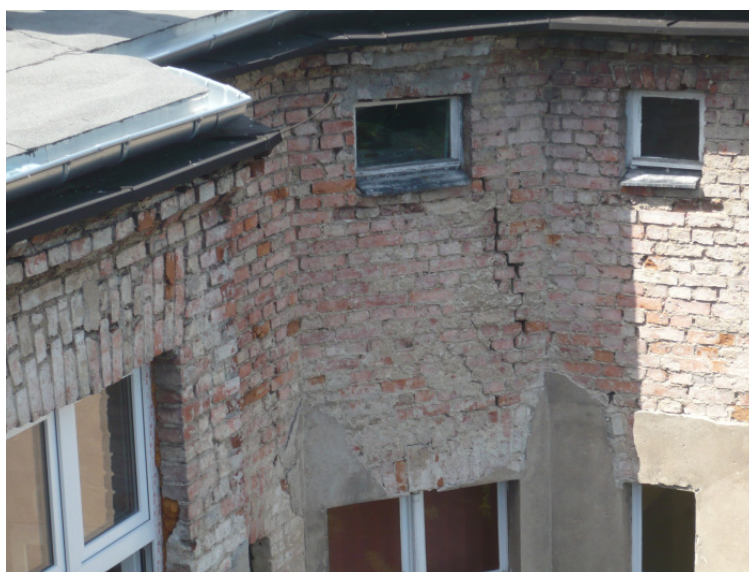
Fot. nr 12. Pęknięcie ściany – elewacja tylna.
