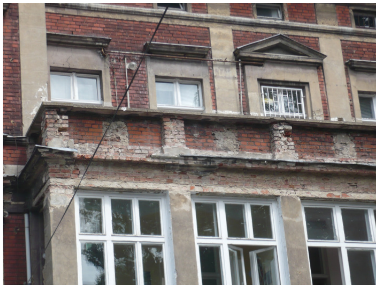
Fot. nr 10. Uszkodzona balustrada tarasu.
