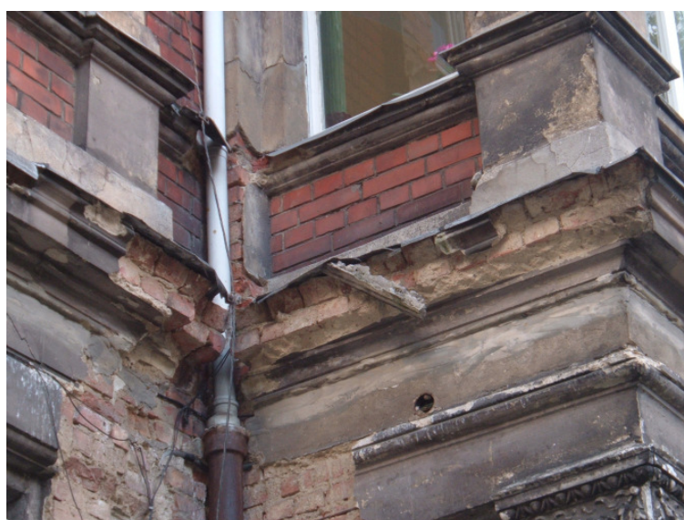
Fot. nr 5. Uszkodzony gzyms nad parterem w części frontowej.
