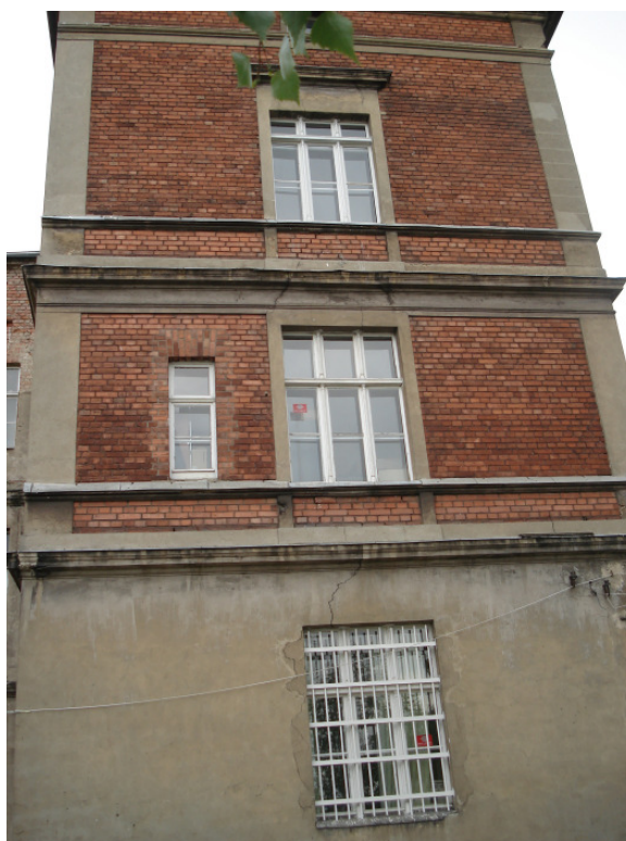
Fot. nr 14. Zarysowanie nadproża i ściany w elewacji tylnej.
