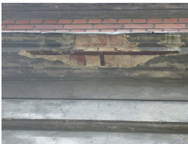
Fot. nr 6. Uszkodzony gzyms nad parterem w elewacji bocznej – widoczna konstrukcja stalowa podpierająca gzyms.
