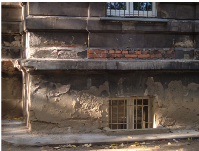
Fot. nr 1. Zawilgocony cokół.
