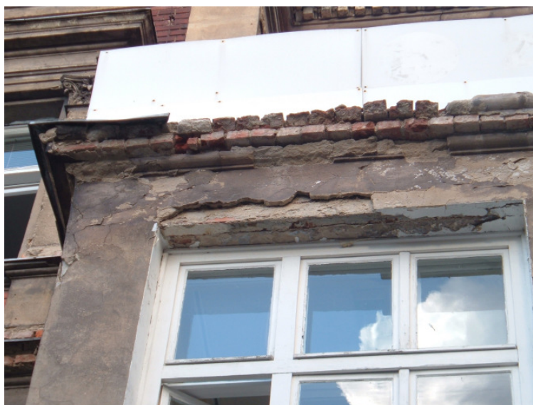
Fot. nr 9. Uszkodzony gzyms tarasu.
