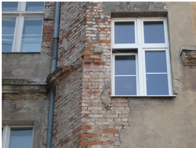
Fot. nr 7. Uszkodzony gzyms ryzalitu klatki schodowej.
