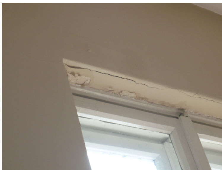
Fot. nr 11. Zawilgocenie nadproża w pomieszczeniu pod tarasem.
