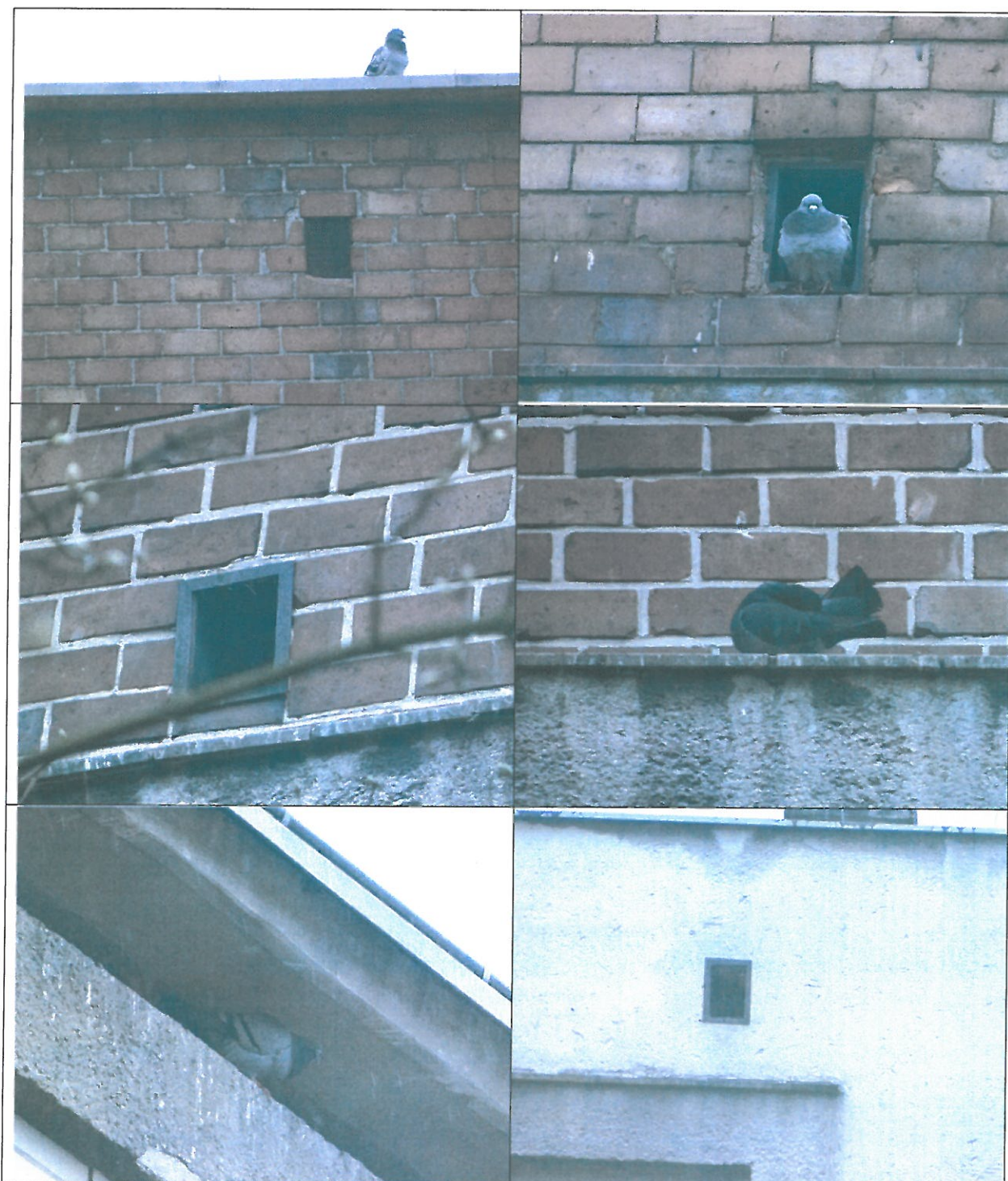
Fot. Gołębie miejskie zasiedlające strefę stropodachu. Widoczne kratki wentylacyjne z uszkodzoną siatką, którymi dostają się do wnętrza gołębie miejskie i mogą dostawać nietoperze.
