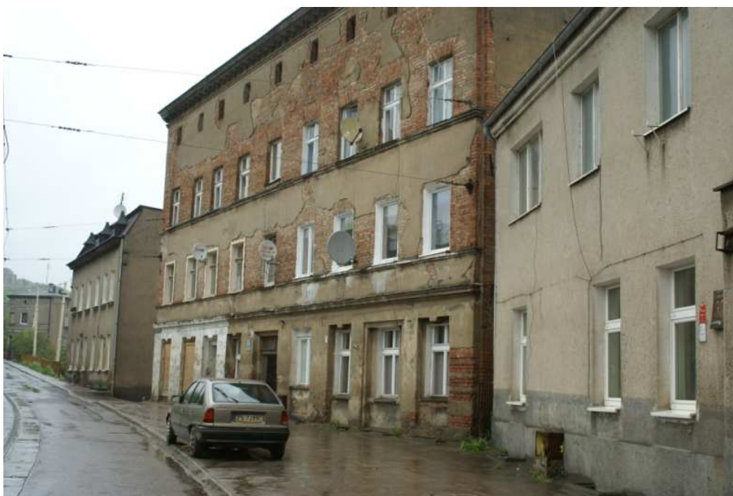
Fot. 6.1-31 Zabudowa mieszkaniowa wielorodzinna w obszarze działania D30 znajduje się w bezpośrednim sąsiedztwie jezdni o złym stanie nawierzchni.
