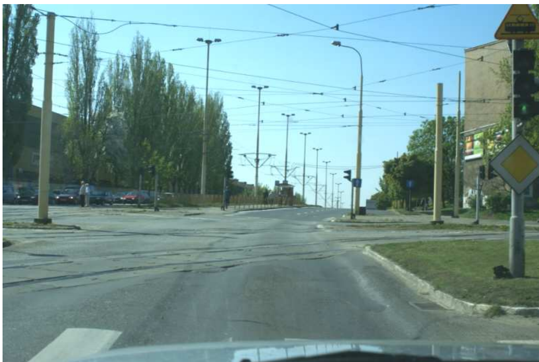
Fot. 6.1-34 Stan jezdni drogi jak i linii tramwajowej na odcinku ul. Dubois i Firlika jest bardzo zły.
